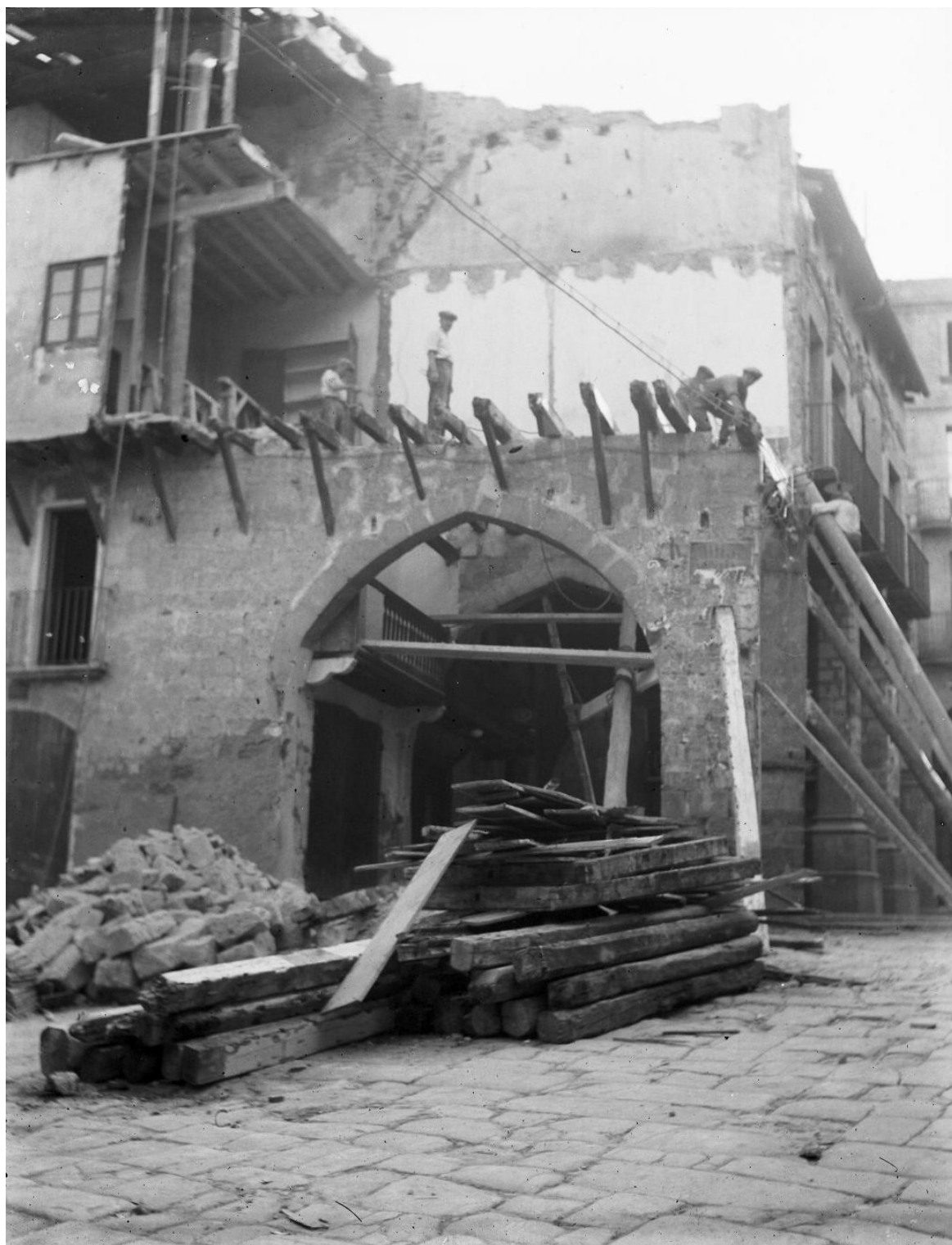
Casa Solé Xarpell. L'edifici va ser desmuntat amb molta brevetat per tal d'evitar ser el blanc de les crítiques. "Gràcies" a aquest fet podem conèixer com era l'estructura interna d'un edifici d'origen gòtic. ACS-FV
